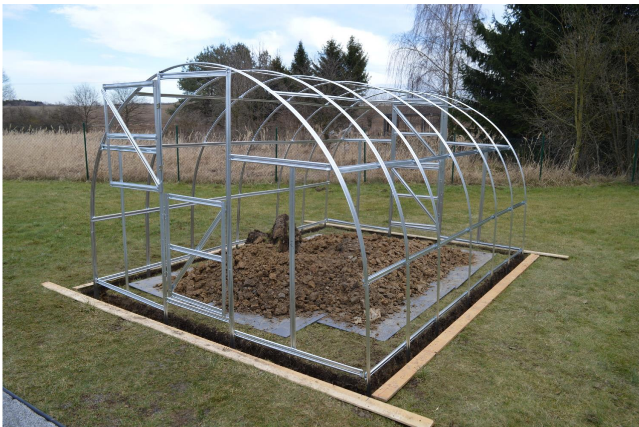
Ilustrativní obrázek ukotvení konstrukce do země (jednotlivé profily se mohou svou polohou odlišovat v závislosti na modelu, rozměru a na roku výroby skleníku )
